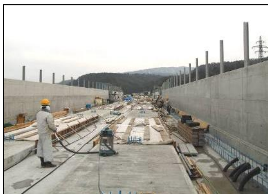
海岸沿いの鉄道線用遮音壁柱
